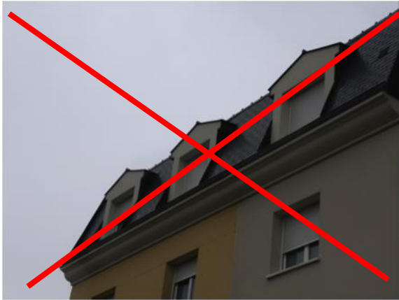
[A éviter : lucarnes préfabriquées en béton mal positionnées]
