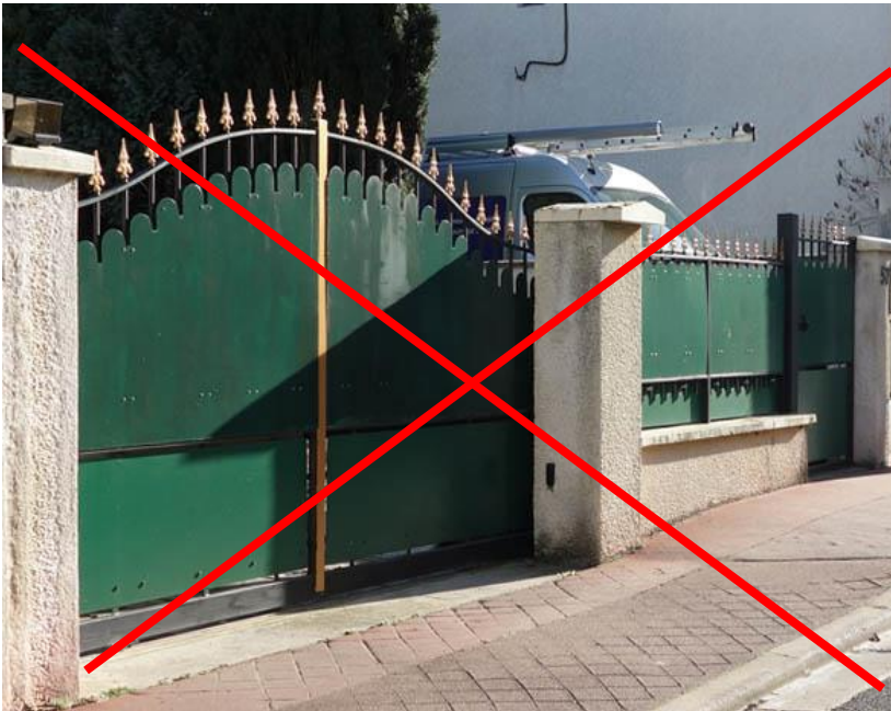
Occultation posée à l'extérieur du barreaudage ; embouts décoratifs surchargés
