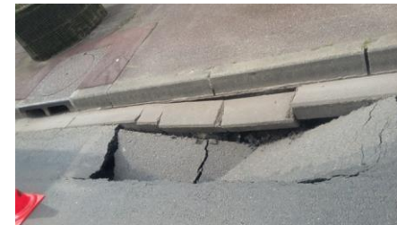
Routes fissurées, effondrements
