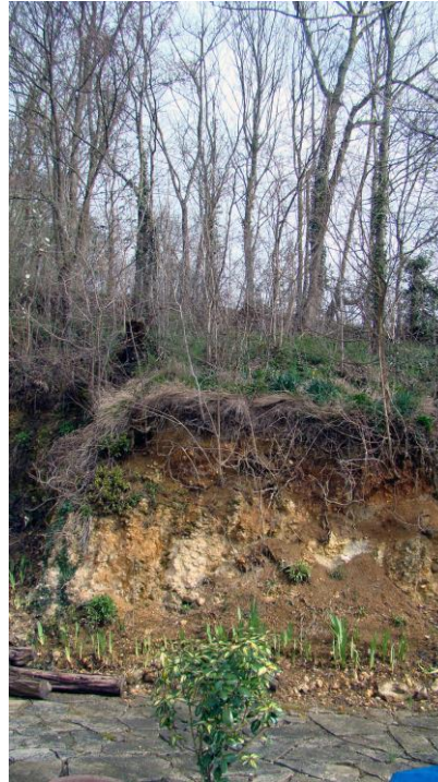
Déboisement sauvage de coteau et pied de coteau terrassé en lisière de bois : désordres à venir ...
