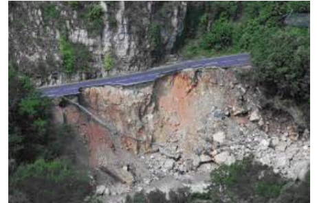
Glissement de terrain
